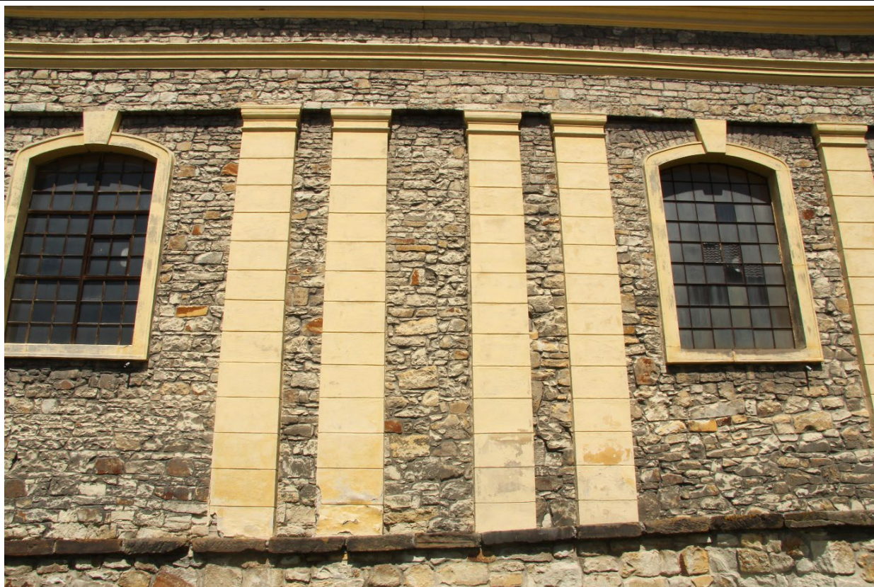
Detail zdí v ose jižního průčelí lodi s méně zřetelnou vertikální spárou mezi dvojicí středních pilastrů. Foto: Jaroslav Skopec 2019.
